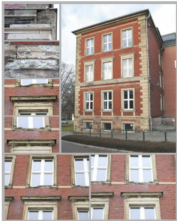
Die beschädigten Gewände unseres Schulgebäudes bestehen aus Hilbersdorfer Porphyrtuff. Der Tuff, dessen farbliche und materielle Zusammensetzung weltweit einzigartig ist, kommt nur im Raum Chemnitz vor.
